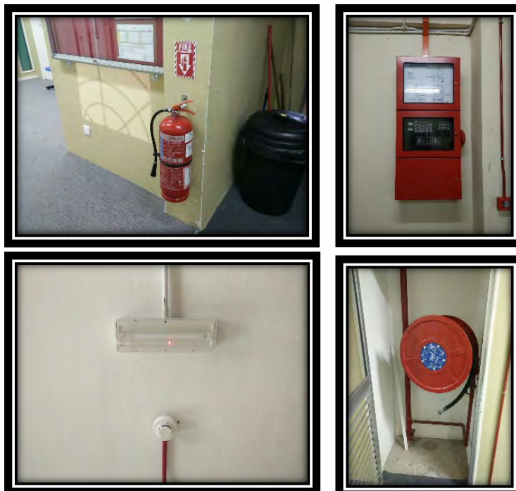
Sistem Penggera Kebakaran
